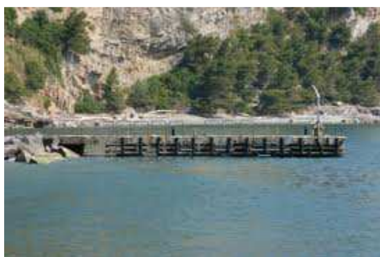
Figura 6. Pontile di attracco delimitante l'area su cui si opererà il risanamento [fonte Google Images].
